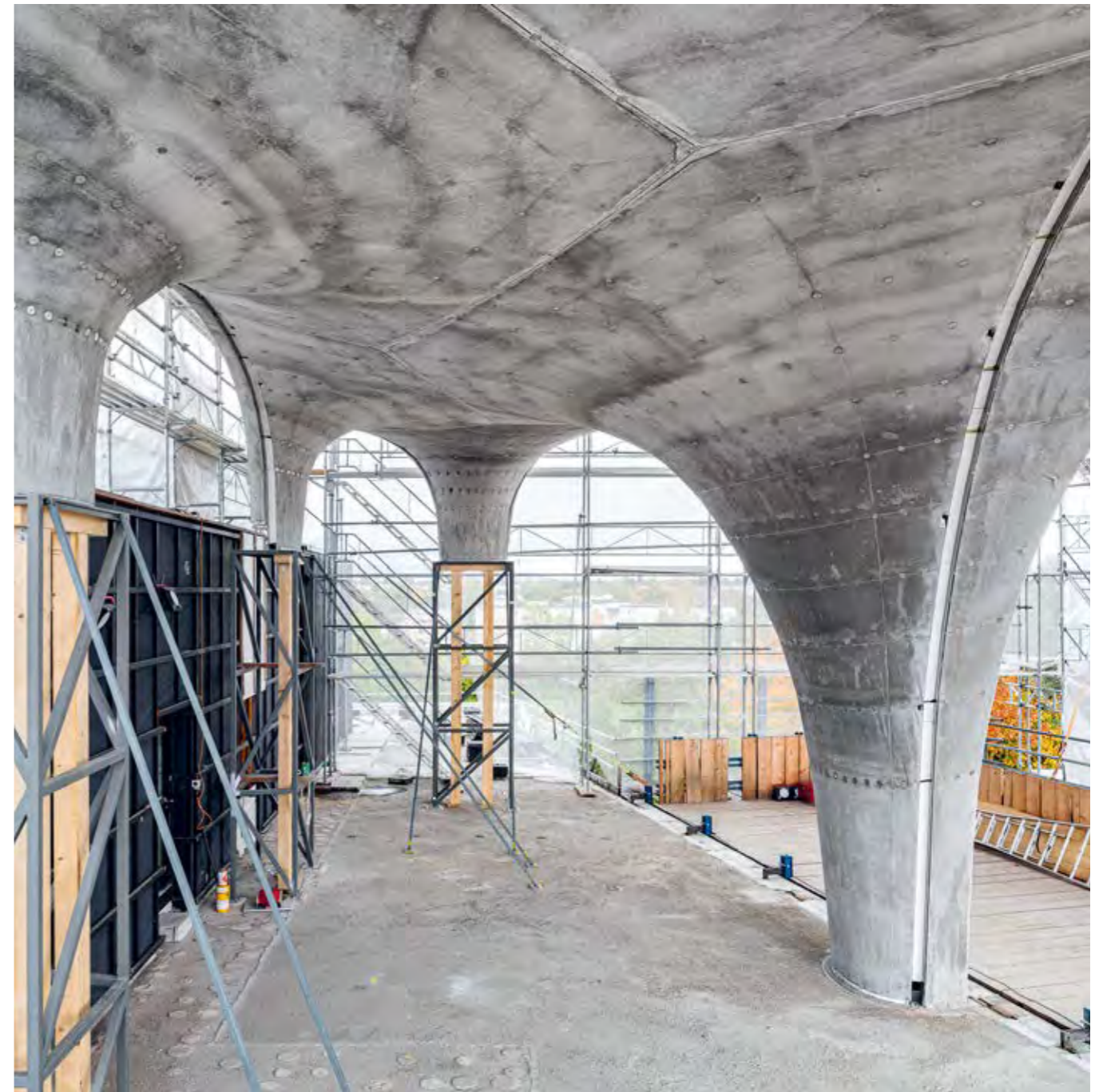
Für das Dach der NEST-Unit «HiLo» wurde der Beton auf eine textile Schalung gesprayed. Foto: Roman Keller
